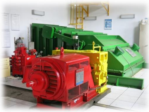
桂山發電廠—水輪機及發電機
