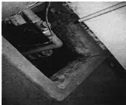
地下室儲水槽
