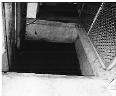
地下室之升降梯孔積水
