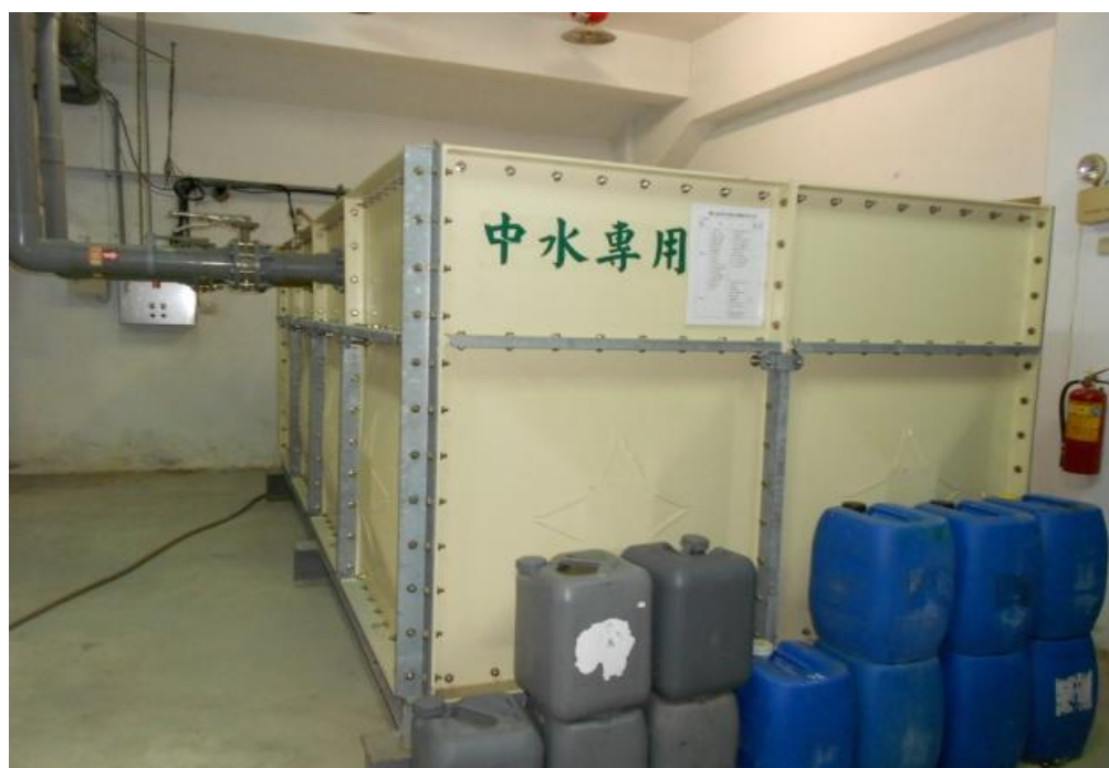
游泳池下有中水回收設置
