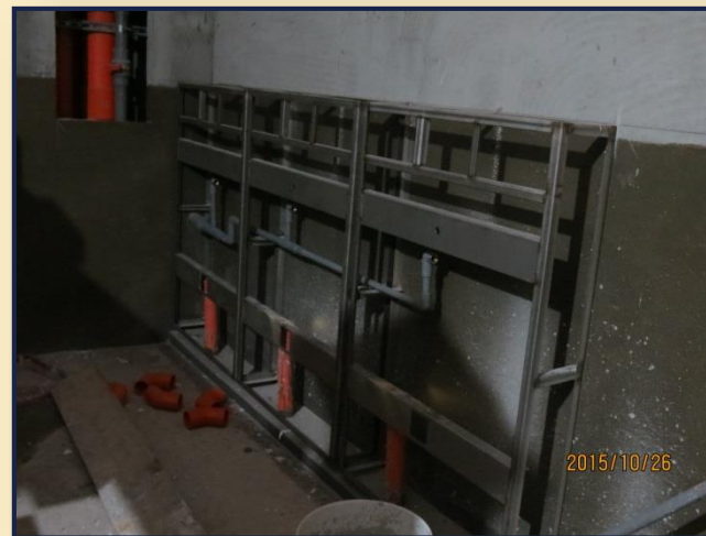
男廁所內小便器UT配管箱
