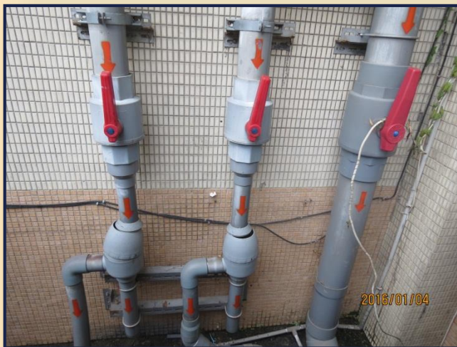
雨水回收過濾設施
