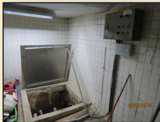
尚德樓地下室箱涵儲水
