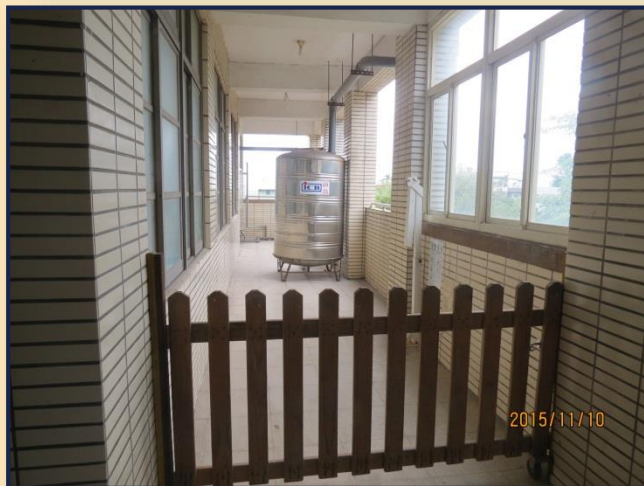
崇德樓雨水回收設施設置位置
