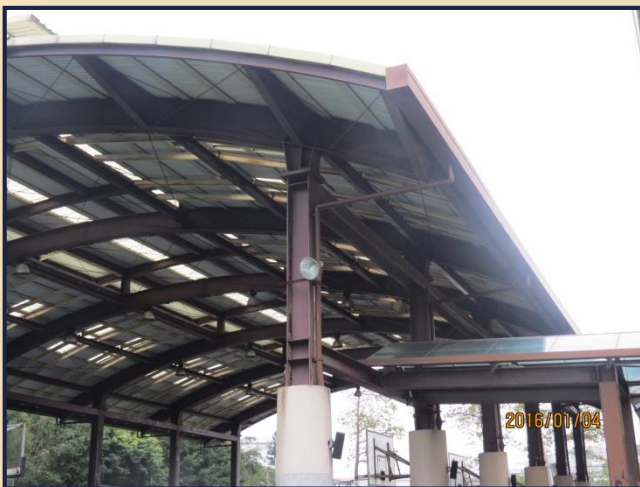
收集風雨操場屋頂雨水
