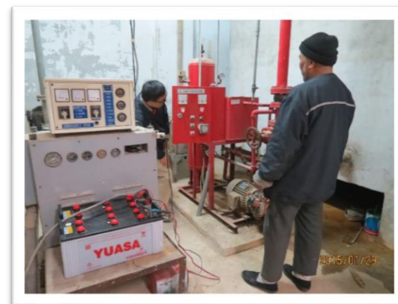
明德樓消防幫浦檢測
