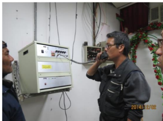
崇德樓火災廣播修復測試
