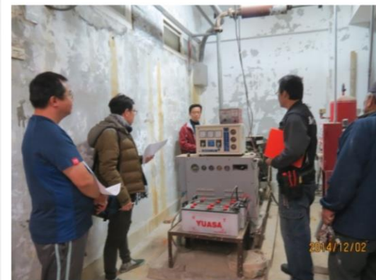
明德樓發電機測試
