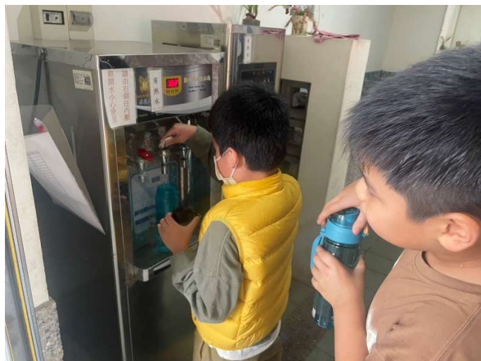
學生自備水壺至飲水機裝水
